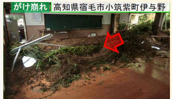
H28年台風16号に伴うがけ崩れ災害(国交省HPより)
