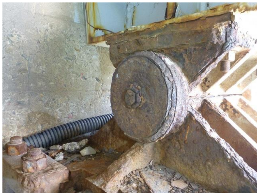
道路橋の支承（※5）部の腐食状況
