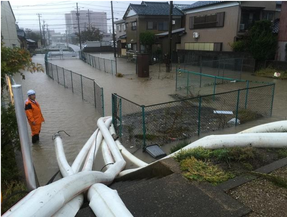
支川古川からの水をポンプアップ
