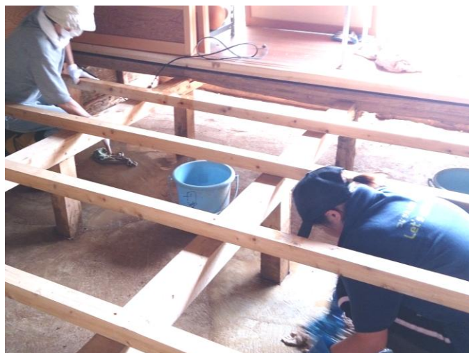
泥がこびりついた床下の土間を雑巾で拭く(29日)
