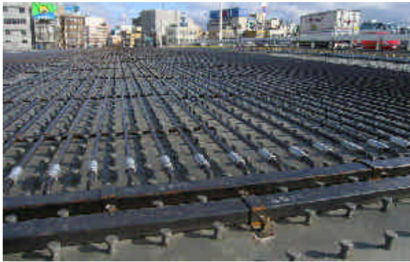
放熱管を設置した状況 融雪面積 3920 m 2 凍結しやすい橋が凍結しない橋に
